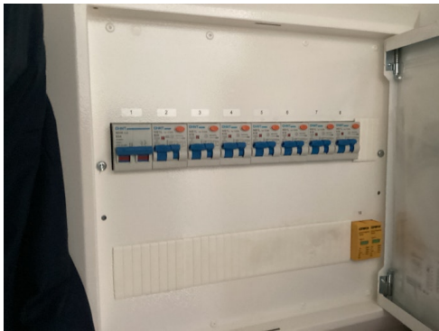
Bilde av sikringskap
