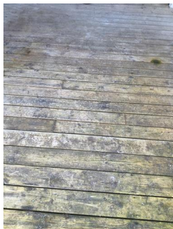
Tilstand på rekkverk og overflatematerialer - Terrassegulv
