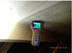
Fuktmåling i område med svertesopp
