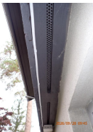
Luftespalte etablert under kledning.
