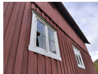
Vinduer, dører og porter - Knust glass og slitasje
