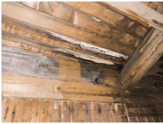
Yttertak og takkonstruksjon - Symptomer på råde i himling
