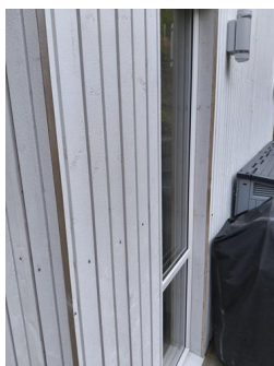
Overflatebehandling - Manglende overflatebehandling
