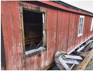
Vinduer, dører og porter - Manglende vindu
