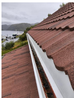
Takrenner og utvendige nedløp - Motfall
