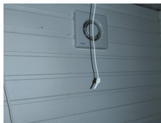
Ventilasjon - Skadet snor
