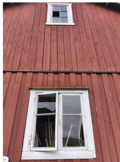
Vinduer, dører og porter - Manglende og knust glass
