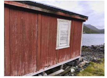
Veggkonstruksjon og fasadematerialer - Slitt overflatebehandling og råteskader
