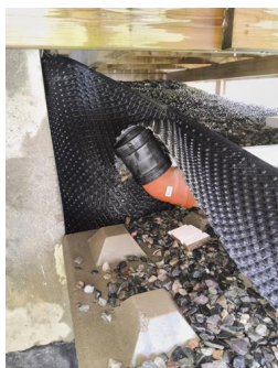
Fuktsikring av grunnmur - Skade på utvendig fuktsperre
