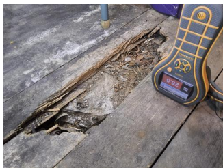
Overflate gulv - Råteskade og fuktmåling i gulv
