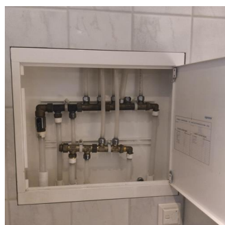
Fordelerskap og fordelerstammer
