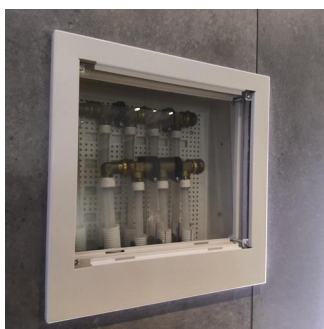
Fordelerskap og fordelerstammer
