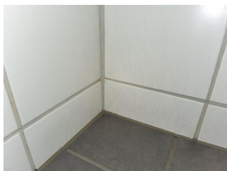
Overflater vegger - Riss veggfliser
