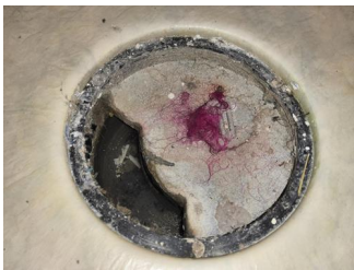
Tettesjiktets tilslutning til sluk - Sluk
