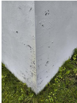
Grunnmur og fundament - Avskalling av murpuss/overflatebehandling og riss
