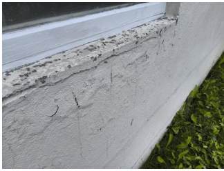
Grunnmur og fundament - Avskalling av murpuss/overflatebehandling
