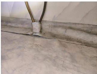
Overflater gulv - Utettheter i belegg
