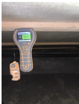
Stikktaking i treverk, fukt og fuktmålinger - Fuktmåling
