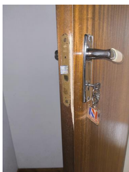
Innerdører - Skade i dør til underretasje
