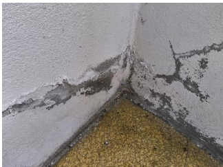
Overflate vegg - Salt og kalk utslag
