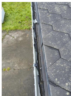
Takrenner og utvendige nedløp - Slitasje på takrenner
