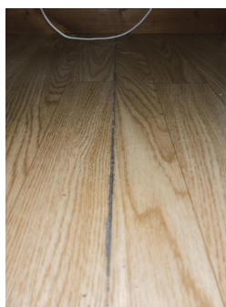
Overflate gulv - Glipper i beleggskjøt
