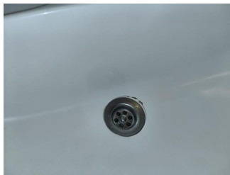
Sanitærutstyr og innredning - Sprekk i servant
