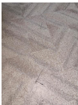
Overflate gulv - Hakk i gulv
