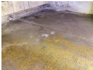
Overflate gulv - Salt og kalk utslag
