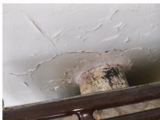
Skorsteiner inne i boligen - Riss i skorstein
