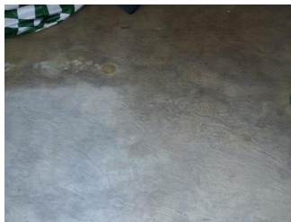
Overflater gulv - Misfarging i belegg
