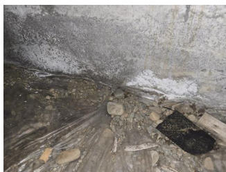
Synlige konstruksjoner - Salt og kalkutslag
