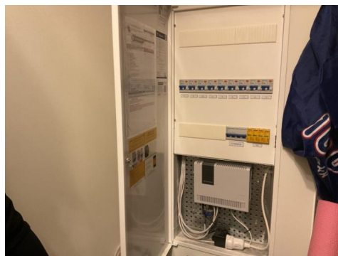
Sikringsskap med automatsikringer.
