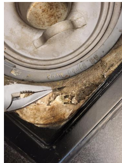
Tettesjiktets tilslutning til sluk - Antydning til mulig skade i slukmansjett
