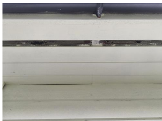
Veggkonstruksjon og fasadematerialer - Skade i fluenetting
