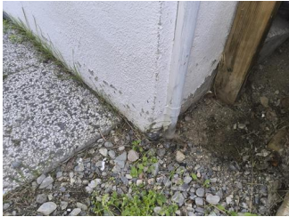
Grunnmur og fundament - Avflassing av maling
