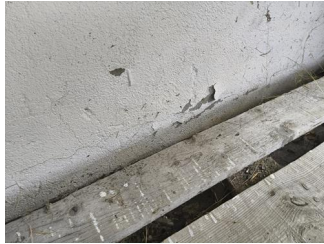
Grunnmur og fundament - Avflassing av maling
