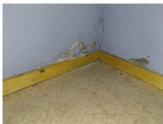
Overflate vegg - Salt og kalkutslag på bod
