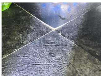
Overflate gulv - Gulvbelegg med redusert vedheft
