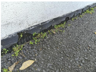
Fuktsikring av grunnmur - Skader i toppleslag
