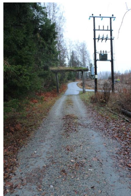
Trafo i mast ved KFUM/KFUK
