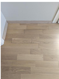
Overflate gulv - Misfarging av gulvoverflate i entré.
