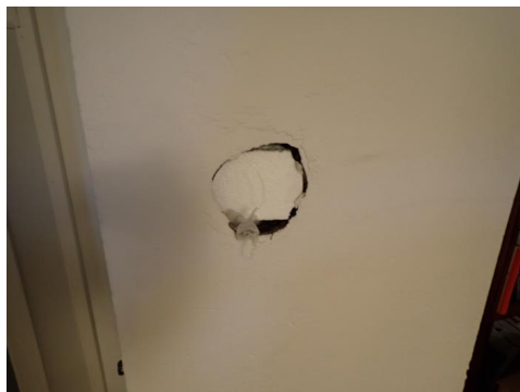
Hull etter gammelt røykrør i kjellerstua er forsøkt tettet med isopor.
