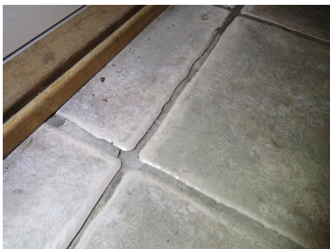
Sprekk i fuge ved inngangsdør.
