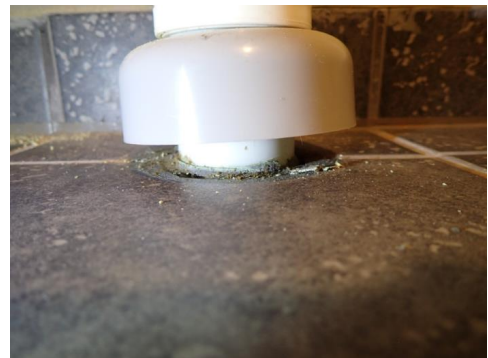
Membran (?) rundt avløp fra vask er skåret skjevt.
