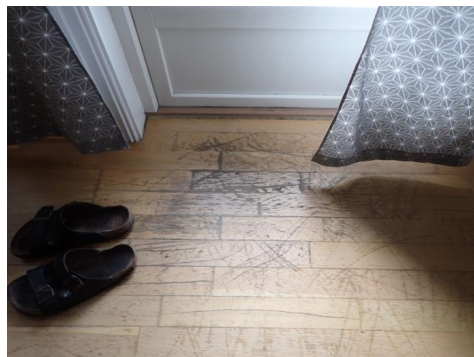
Slitasje i parkett ved verandadør.
