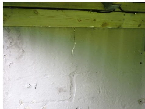
Eksempel på mindre oppsprekking (mot vest)
