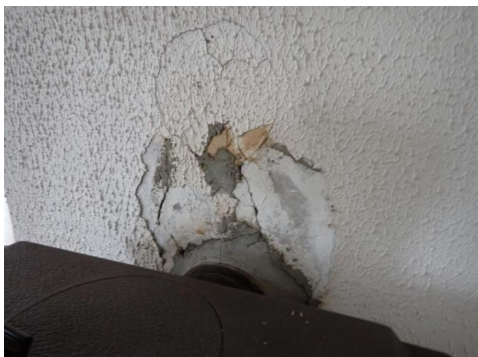
Skader/løs puss over ovn i stua.
