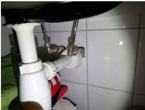
Manglende fuktsikring rundt vannrør.
