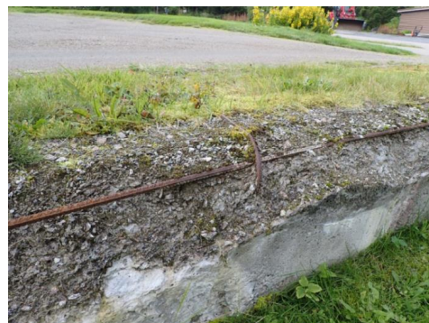
Forstøtningsmur, armering ligger åpen.
