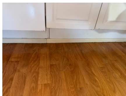
Sår og hakk, noe trapping mellom fronter.
