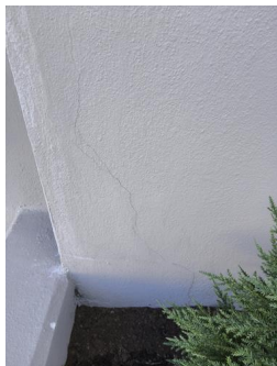
Grunnmur og fundament - Riss i grunnmur ved garasjeport
