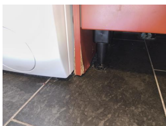
Sanitærutstyr og innredning - Svelleskade
