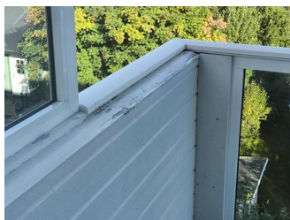
Tilstand på rekkverk og overflatematerialer - Slitt overflatebehandling
