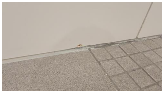
Overflater vegger - Skade på veggflis
