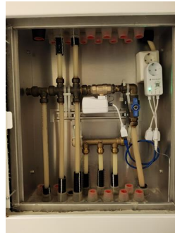
Fordelerskap og fordelerstammer - Fordelerskap
