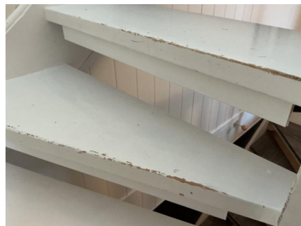
Eksempel på slitasje
