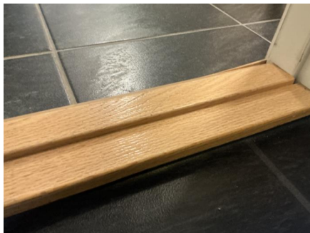
Dørterskel uten luftespalte
