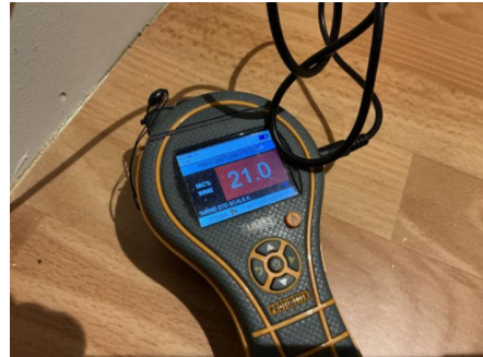
Forhøyede fuktverdier på kontrollert sted på innvendig utlektet grunnmur, er høyere enn normalverdier.
