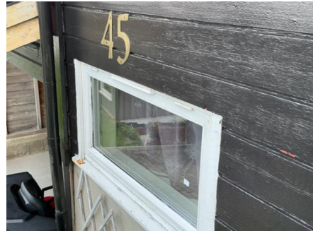
Eksempel på manglende beslag
