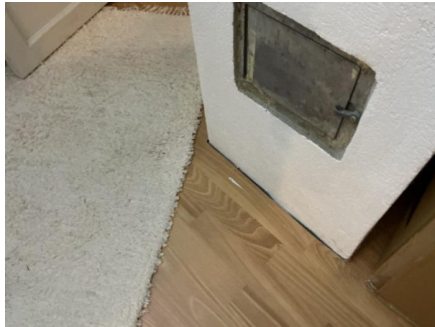
Ubrennbar plate på gulv ved sotluke mangler
