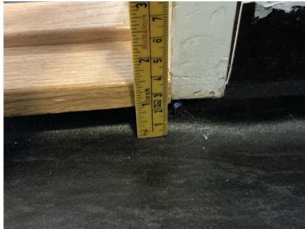
Oppbrett av belegg ved dør
