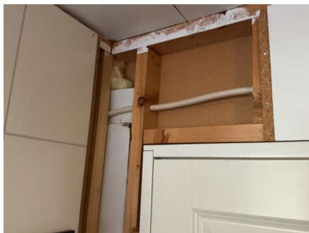
Eksempel på manglende overflatemateriell (og dørlister).
