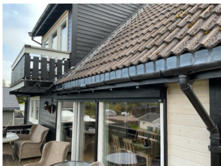
Eksempel manglende snøfanger
