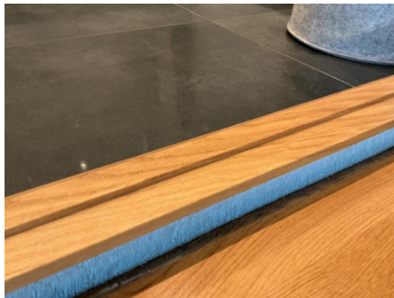
Dørterskel uten luftespalte
