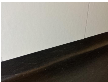
Manglende sokkellist på baderomspanel
