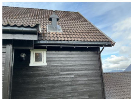
Eksempel manglende snøfanger
