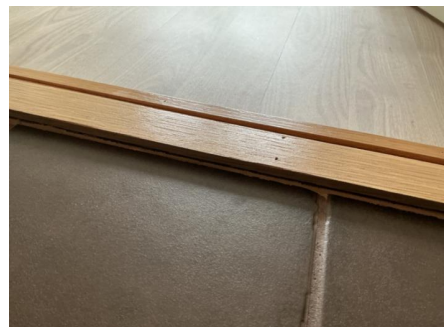
Manglende oppbrett av membran ved dør
