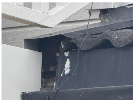
Forkantbeslag ikke ført helt inntil vegg.
