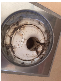
Ingen indikasjoner på membran i sluk på vaskerom
