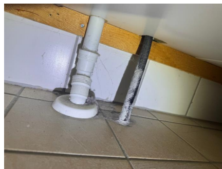
Ikke synlig mansjett rundt rørgjennomføringer i gulv
