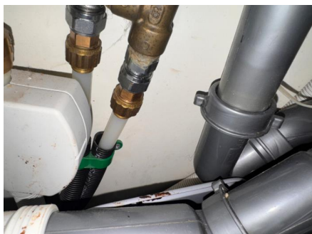
Ikke montert tettemuffer i overgang mellom ytterrør og innerrør.
