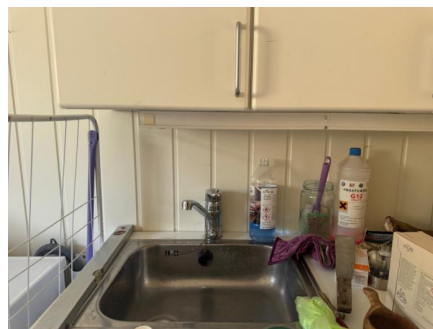
Ikke tettesjikt på vegg bak vask i rommet
