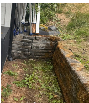
Mose på overflater og noe skjevheter i mur
