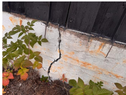
Omfattende sprekker i grunnmur grunnet setninger
