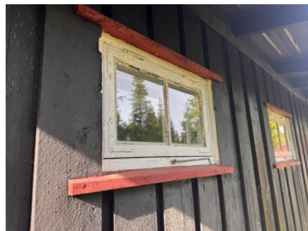
Gamle og slitte vinduer
