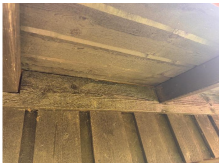
Ingen lufting i nedre del av takkonstruksjon
