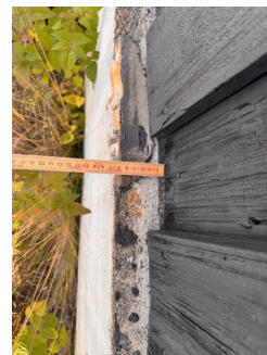
Grunnmur har glidd ut og ligger utenfor vegg, dette medfører økt risiko for fuktskader i nedre del av veggkonstruksjon.
