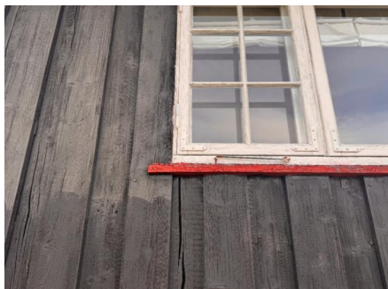
Slitasje i vinduer og ikke montert beslag under vinduer
