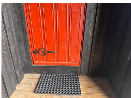
Ytterdør med noe malingsslitasje og justeringsbehov
