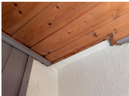
Fuktmerker i himling rundt pipe
