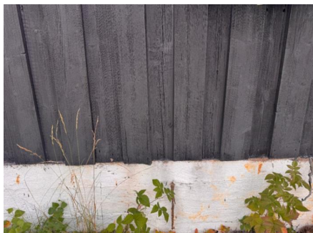
Vridde panelbord og lokal råte i panel
