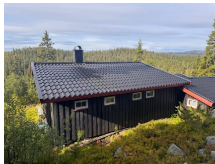
Ikke montert takrenne
