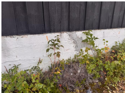
Setningssprekker i grunnmur
