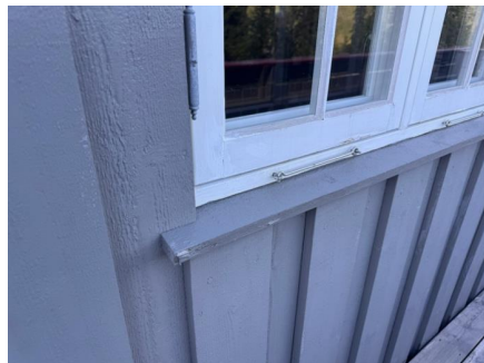
Ikke montert beslag under vindu
