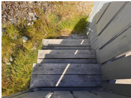
Trapp med råte i nederste trinn
