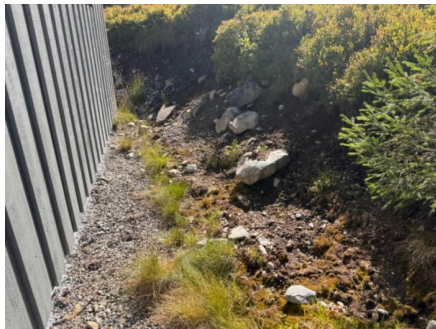
Terreng som heller mot bygningen
