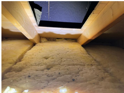
Ekskrementer av mus på kaldloft
