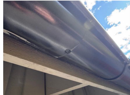
Lekkasje i skjøt av takrenne
