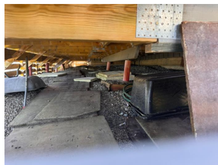
Skjevheter i opplagring under veranda
