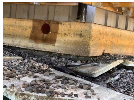
Utglijning av masser under deler av grunnmur
