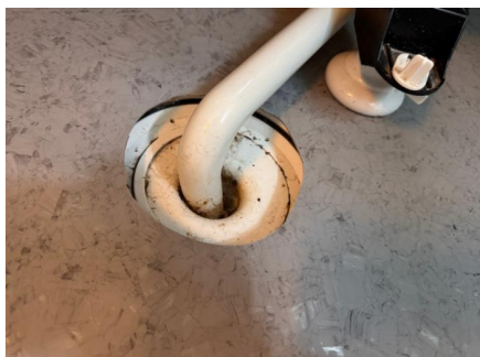
Ikke vanntett overgang mellom sluk og belegg på hyttebad
