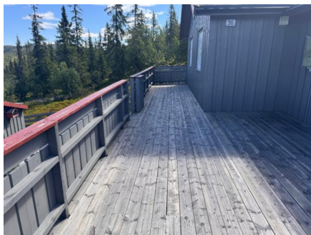
Skjevheter i veranda
