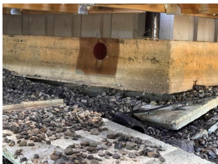
Utglijning av masser under deler av grunnmur
