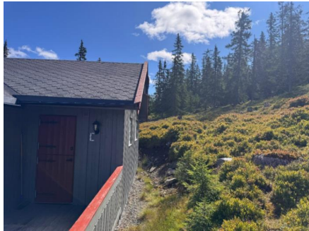
Noe skjevhet i takrenner
