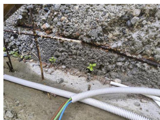
Grunnmur og fundament - Eksponert armering
