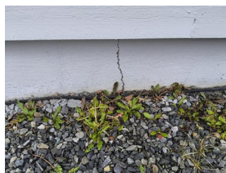
Grunnmur og fundament - Sprekk i grunnmur
