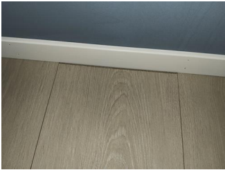
Overflate gulv - Glippe mot veg
