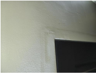
Overflate vegg - Ikke preg av god fagmessig utførelse
