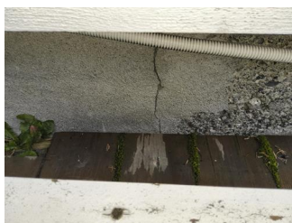
Grunnmur og fundament - Sprekk i grunnmur
