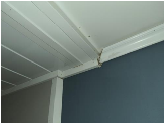
Overflate vegg - Ikke preg av god fagmessig utførelse
