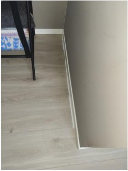
Overflate gulv - Glippe som er fuget
