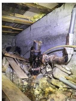
Synlige rør og rørføringer (utover det som nevnes under andre sjekkpunkter) - Lufting til avløp i krypekjeller
