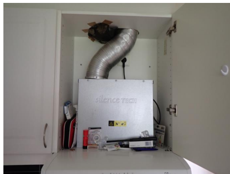
Ventilator på kjøkken. Rør til bad/vaskerom er koblet fra.
