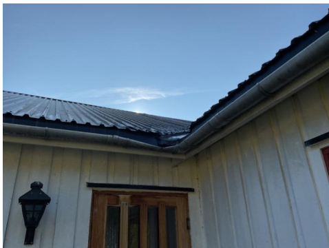
Deformering på takrenne over inngangsparti. Ved større vannmengder vil vann kunne renne over kanten her.
