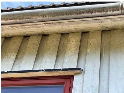
Slitt overflate, med behov for rengjøring og vedlikehold.
