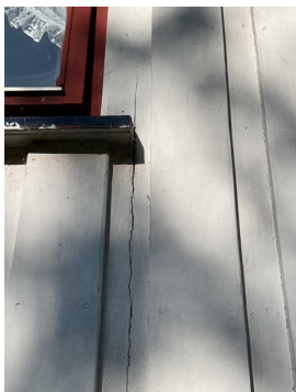
Oppsprekninger stedvis som følge av aldring.
