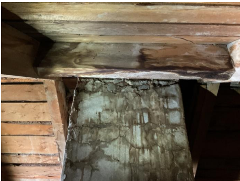
Fuktskjolder og delvis råteskadede materialer.
