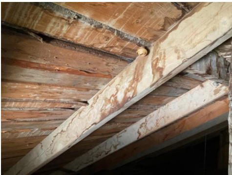
Fuktskjolder og delvis råteskadede materialer.
