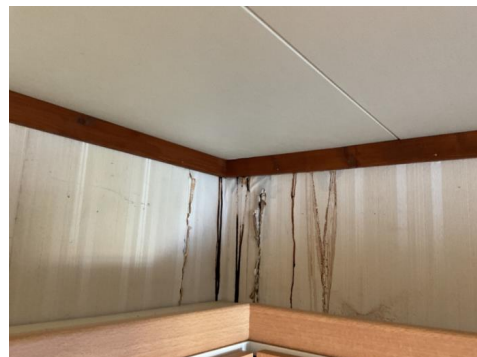
Merker på vegg, trolig som følge av sotvann fra pipe.
