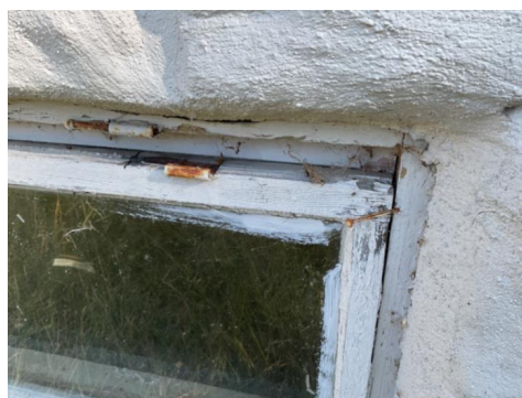
Vinduet er råteskadet, og innfestning er ødelagt.
