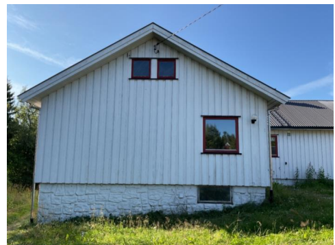
Fasader fremstår med varierende slitasjegrad.
