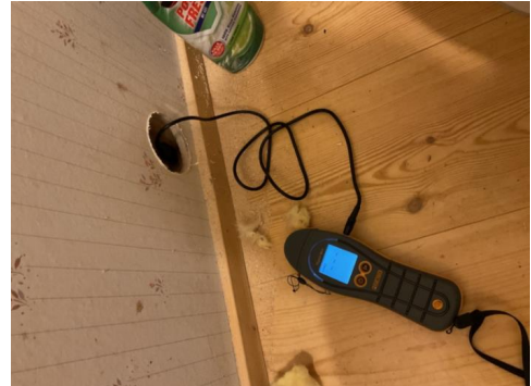
Fuktmåling i tilleggende konstruksjoner.
