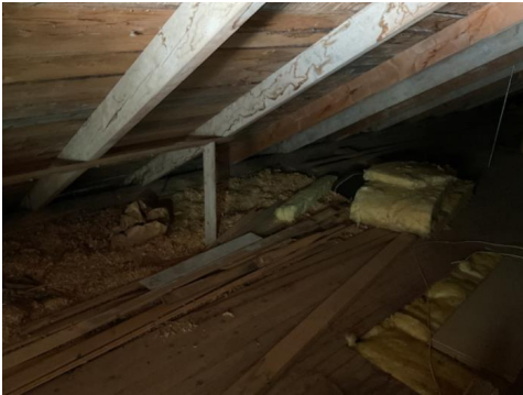
Takkonstruksjonen har ikke tilfredsstillende lufting.
