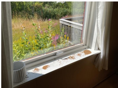
Malingsavflassing i karm, tegn til innvendig kondensering på karm.
