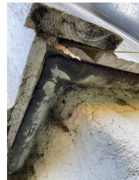
Manglende lufting bak kledningen.
