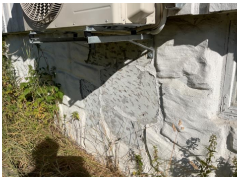
Manglende utvendig forblending.
