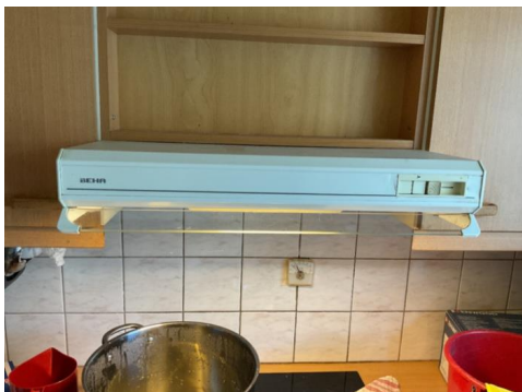
Kjøkkenventilator med avtrekk ut.
