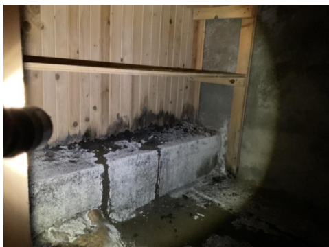
Synlig vann på gulv i kjeller. Råteskader på tilstøtende treverk.
