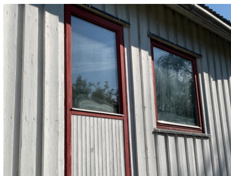
Punkterte glass i balkongdør og i vindu.
