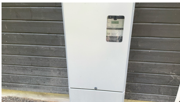
Inntaksskap på yttervegg med strømmåler.
