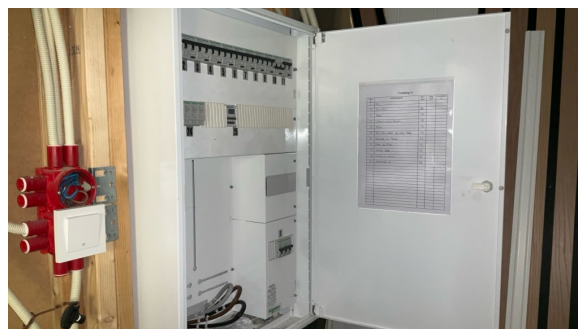
Sikringsskap med automatsikringer er plassert i sportsbod.
