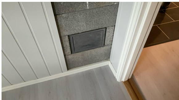
Ildfast plate mangler på gulvet under sotluke
