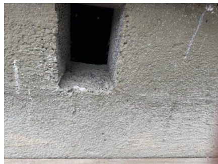
Eksempel på manglende sikring av ventiler
