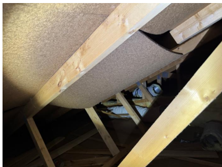
Eksempel på stedvis løsnet/ skadet undertaksplate.
