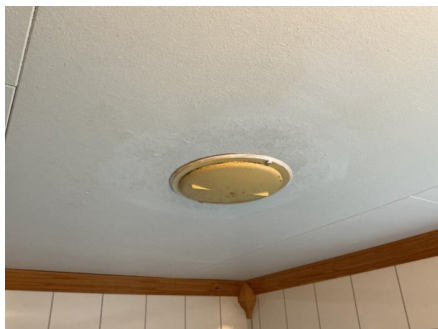
Eldre fuktskade ved ventil i himling
