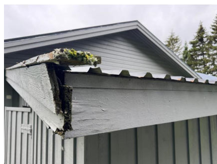
Eksempel på råteskade
