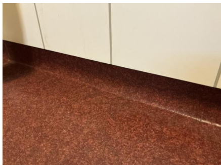
Eksempel på manglende bunnlist
