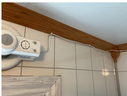
Ikke fagmessig utførelse
