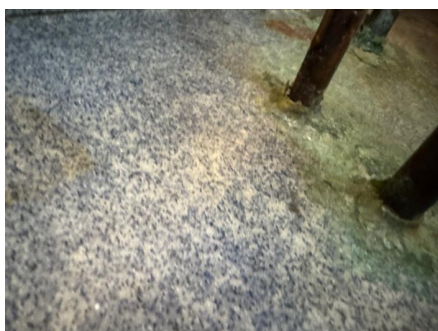
Utetthet ved rørgjennomføring
