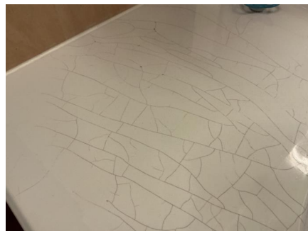
Eksempel på riss på servantbeslag
