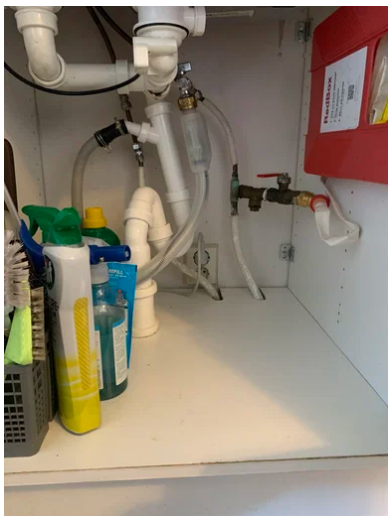
Avløp under kjøkkenbenk
