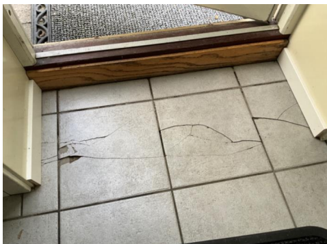
Sprekker i fliser i entre
