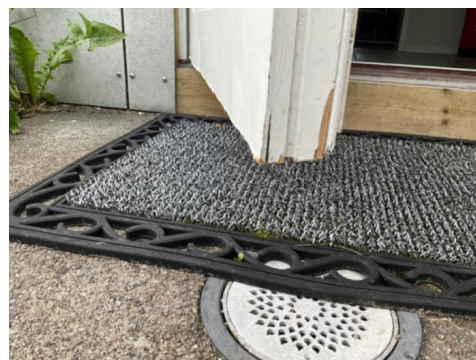
Svelling/råte i dørblad på inngangsdør til leilighet 1
