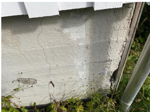
Sprekk i grunnmur av betong
