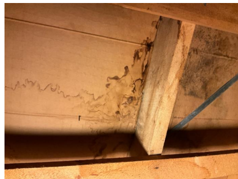
Fuktskjold i undertak på kryploft
