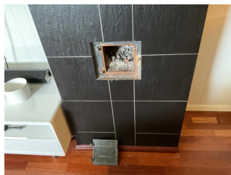
Mursteinpipe med defekt sotluke
