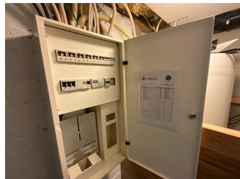
Sikringsskap for L1 og garasje
