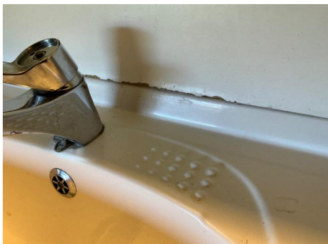
Svellskader i innredning
