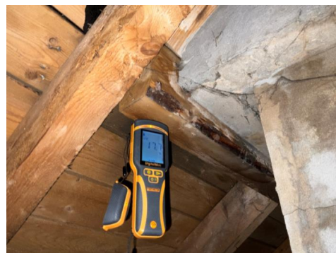
Fuktmåling med påvist svakt forhøyede fuktverdier rundt pipe på kryploft i originalt bygg.
