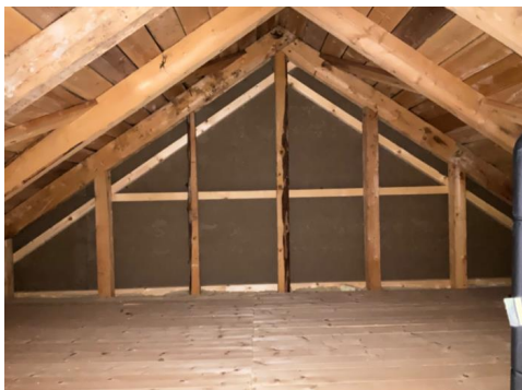
Ingen lufteventil på loft
