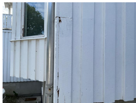
Spredte råteskader i trekledning
