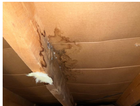
Fuktskjold i undertak og sperre
