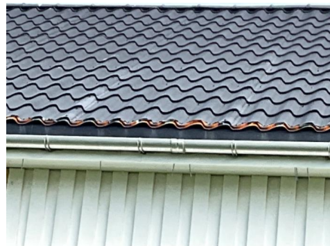
Rust i takplater
