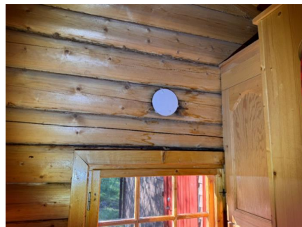
Fuktmerker rundt ventil på soverom
