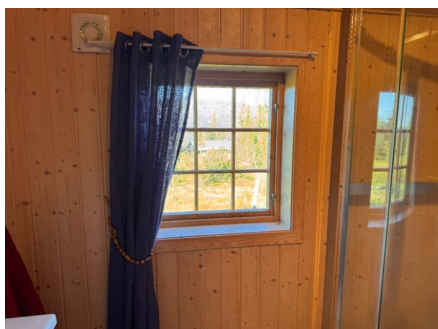
Ikke membran på vegger i våtsone
