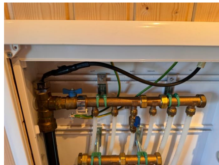
Stoppekran i vannskap
