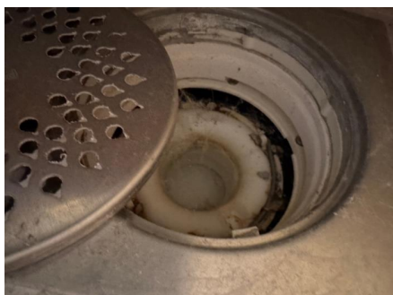
Sluk under kabinett der det ikke er synlig membran
