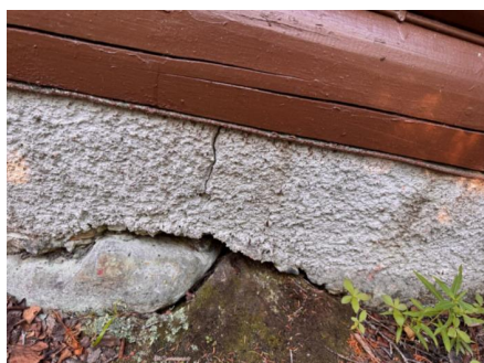
Sprekk i grunnmur som tyder på noe bevegelse i grunn under mur
