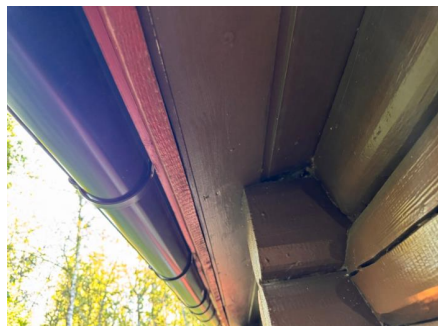
Begrenset lufting i nedre del av takkonstruksjon
