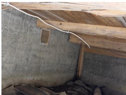
Treverk som er festet til mur og ført ned til bakken med råteskader.
