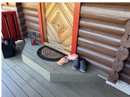
Ytterdør fra byggeår med noe slitasje
