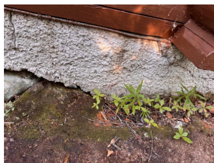
Sprekk i grunnmur som tyder på noe bevegelse og noe synk i masser lokalt under mur.
