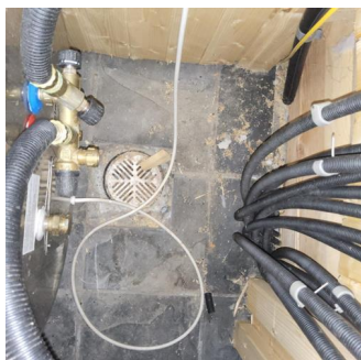
Konstruksjonsoppbygging - Eksempel på manglende tettesjikt og spor etter skadedyr/mus under benker
