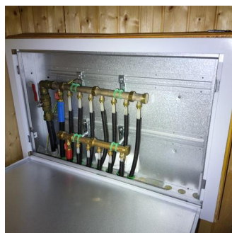
Fordelerskap og fordelerstammer - Plassert i badstue
