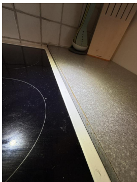
Svelleskade mot ende av benkeplate ved komfyr.
