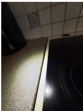
Svelleskade mot ende av benkeplate ved komfyr.
