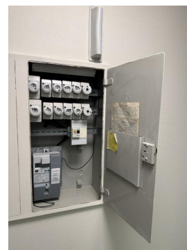
Sikringsskap plassert i trappegang, med skrusikringer.
