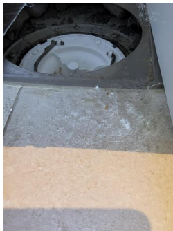
Avløp (inkl. sluk) - Sluk ved vaskemaskin
