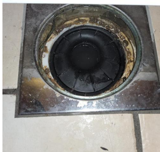
Helhetsvurdering - Sluk under dusjkabinett
