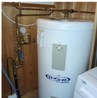
Varmtvannsbereder - Varmtvannsbereder, hovedstoppekrane og vannmåler plassert i vaskerom
