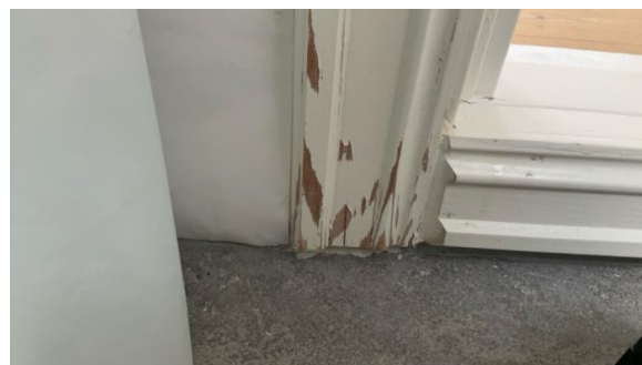
Fuktskader på gerikt ved dør.
