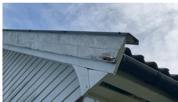
Råteskader på vindski
