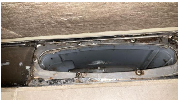
Veggsluk i dusjsone. Synlig membran/ slukmansjett i sluket. Ukjent type membran/tettesjikt.
