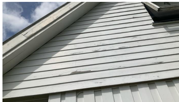
Stedvis malingsflass og kledning fremstår noe værslitt.
