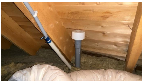
Lufting på avløp er ikke ført over tak. Bilde tatt på loftet.
