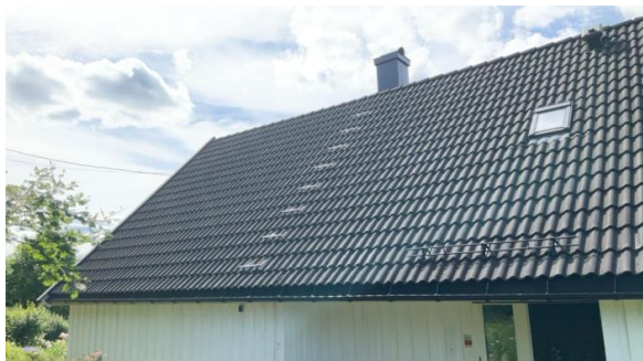
Det mangler snøfanger på deler av takflatene.
