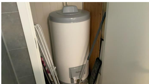
Varmtvannsbereider på ca. 200L er plassert i kjeller.
