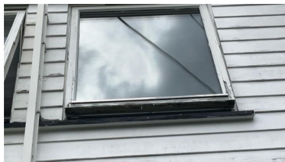
Enkelte vinduer er værslitte utvendig.
