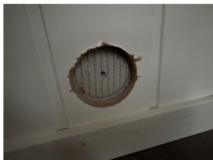
Det ble påvist mur i tilstøtende konstruksjon ved hulltaking. Fuktmåling var derfor ikke mulig.
