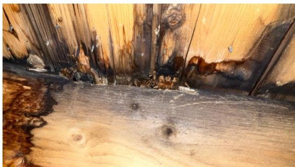
Råteskader i undertak.
