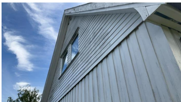
Svertesopp på kledning.
