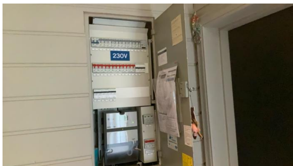
Sikringskapp med automatsikringer er plassert i gang
