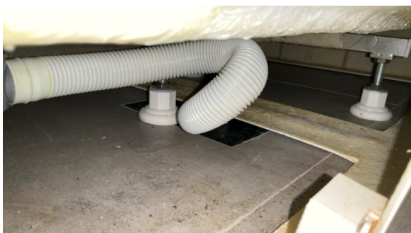
Sluk under badekar hadde begrenset adkomst. Sluk/ slukmansjett er ikke kontrollert. Det oppfordres til ytterligere undersøkelser.
