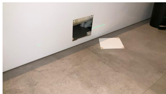
Inspeksjonsluke i badekar. Begrenset adkomst for inspeksjon og rengjøring av sluket.
