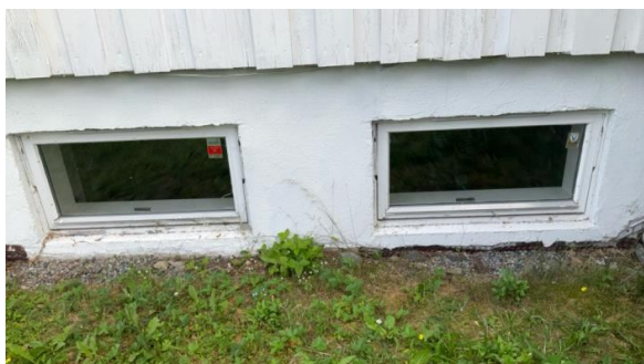
Lav høyde mellom terreng og kjellervinduer.
