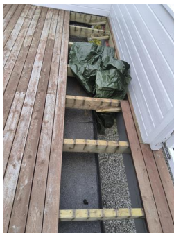
Membraner og vanntett sjikt - Pågående fuktskade under utbedring
