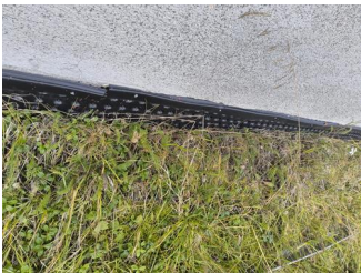
Fuktsikring av grunnmur - Løst toppbeslag
