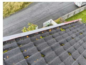
Vannbord, vindskier, gesimskasser og lignende - Slitt vannbord
