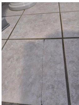
Overflater gulv - Sprekk i to fliser ved toalett
