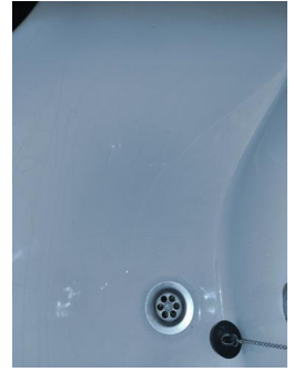
Sanitærutstyr og innredning - Sprekk i servant
