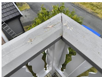
Tilstand på rekkverk og overflatematerialer - Slitt håndløpet
