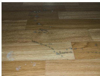
Overflate gulv - Hakk/skader i gulv
