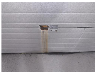
Vinduer, dører og porter - Skade i port hengsel med rust
