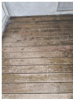
Tilstand på rekkverk og overflatematerialer - Slitasje
