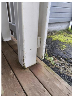
Tilstand på rekkverk og overflatematerialer - Slitasje
