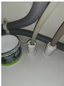
Vannrør - Skadet plugg mellom vannrør og varerør
