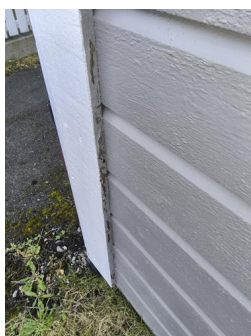
Veggkonstruksjon og fasadematerialer - Slitt overflatebehandling
