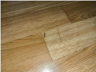
Overflate gulv - Ripe og hakk i stuegulv i leilighet
