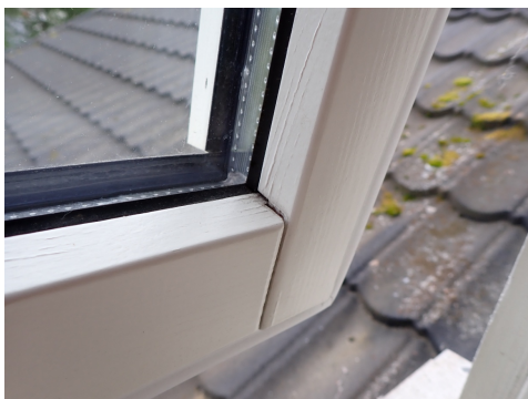
Nedre del løsner fra resten (vindu mot øst)
