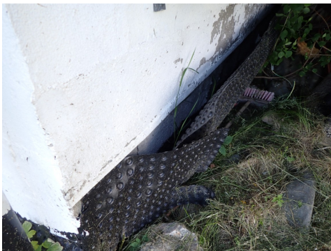
Eksempel på glipper mellom grunnmursplast og mur
