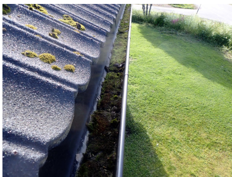
Takrenne på hovedtak mot sør er full av mose
