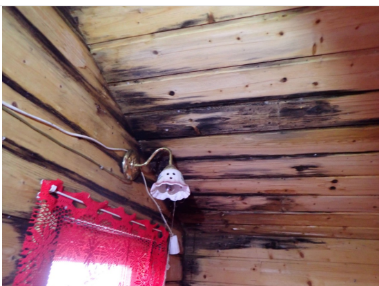
Fukt- og råteskader innvendig
