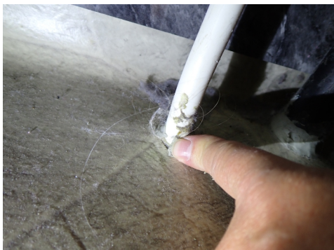
Fuging mellom belegg og vannrør løsner
