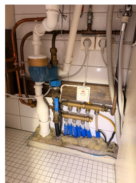
Vannledninger og fordelere på bad.
