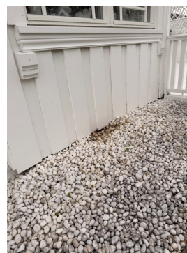
Ytterkledningen går helt ned i terreng, og det er i dette området registrert mauraktivitet.
