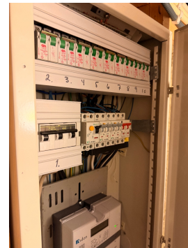
Sikringsskap med automatsikringer.
