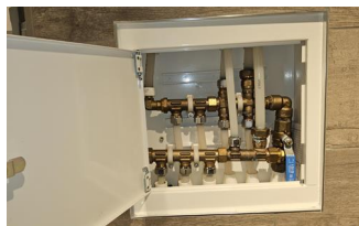
Fordelerskap og fordelerstammer - Fordelerskap.
