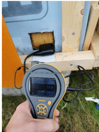
Fukt i stender ned mot ringmur, bak vindspærre
