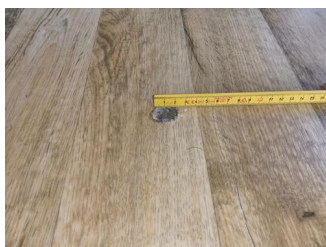
Overflate gulv - Skade i stuegulv
