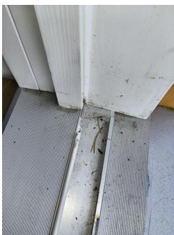
Ytterdører og omramming - Skade i pakning på terrasedør
