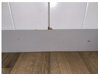
Innredning - Skade i skap
