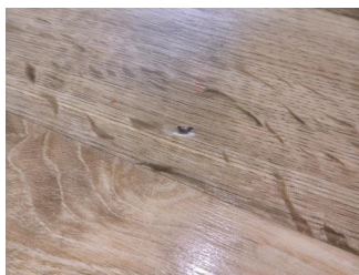
Overflate gulv - Hakk i gulv
