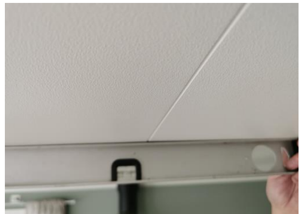
Takplater ikke rette. Luftlomme mellom vater og takplater
