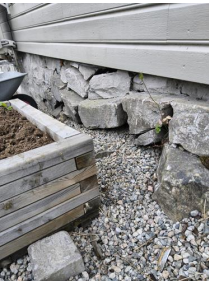
Grunnmur og fundament - Store åpninger i mur.
