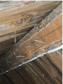
Borebiller - Bjelker angrepet borebille/husbukk
