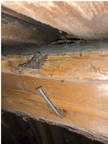
Borebiller - Synlige tegn etter borebille/husbukk
