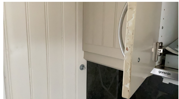
Skader i flere fronter.
