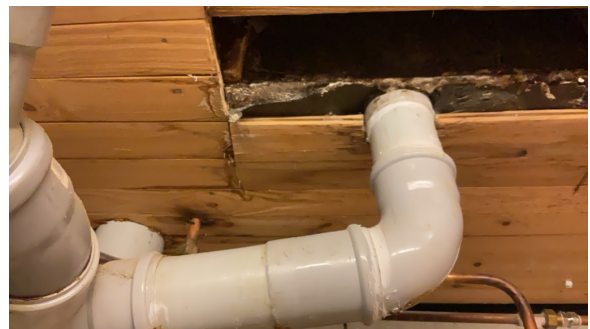
Utslag ved fuktsøk i himling under badet.
