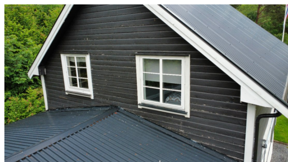
Oversikt vegg mot vest, synlig værslitasje
