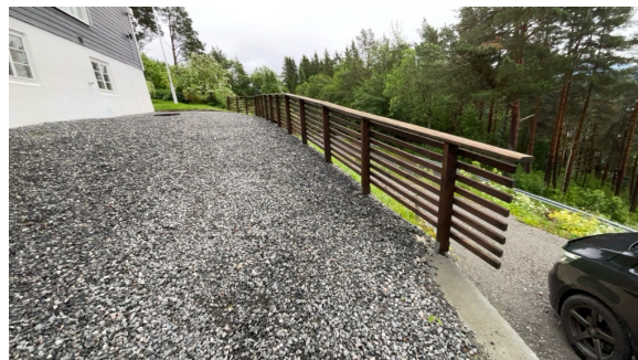
Spalteåpning mellom spiler på rekkverk er for stor i henhold til gjeldende krav.
