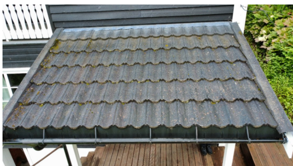
Tak over inngang. Noe synlig mose
