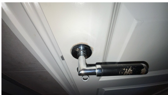
Slitasje på dør rundt dørvrider
