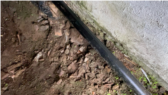
Ingen synlig grunnmursplast under overbygd veranda på siden av boligen
