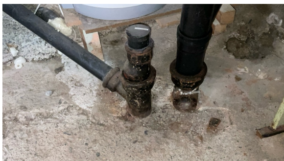
Soil avløpsrør er synlig i kjeller
