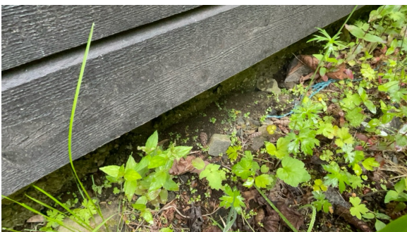
Ingen synlig grunnmursplast på oversiden av boligen
