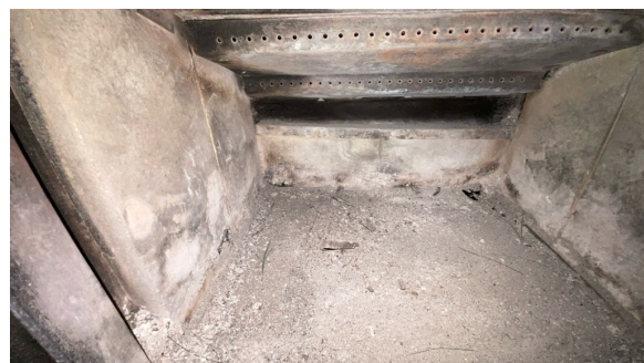
Sprekk i stein i ovn
