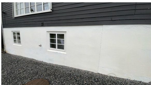
Sprekk i skille på grunnmur ved tilbygg
