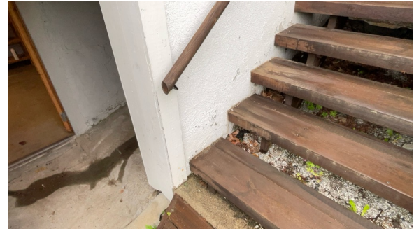
Ingen synlig grunnmursplast ved trapp på siden av boligen
