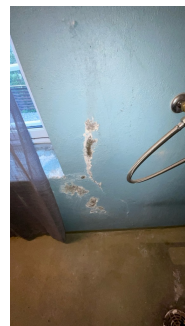
Saltutslag og misfarging innvendig på mur
