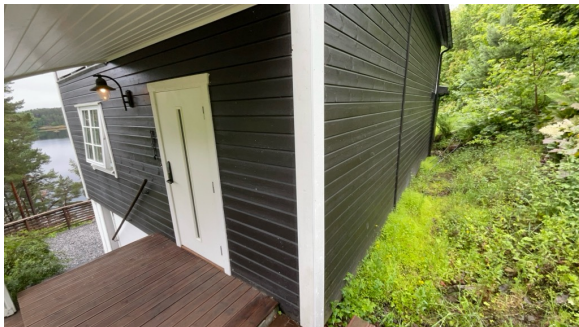
Oversikt. Bør fjernes gress som vokser opp mot kledningen.
