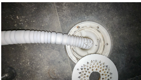
Sluk under dusjkabinett
