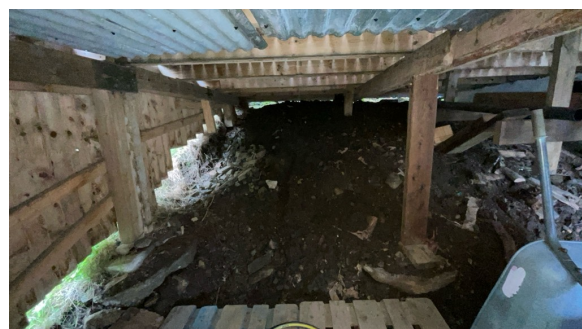
Fundamentene er opplagret med trepilarer direkte på stein og jord, noe som anses som en svak fundamentering.
