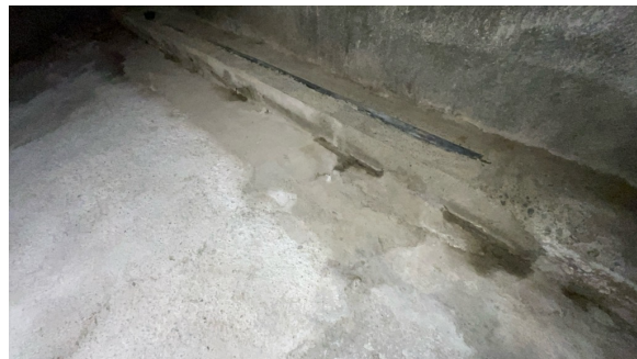
Fuktgjennomslag i øvre lagerrom
