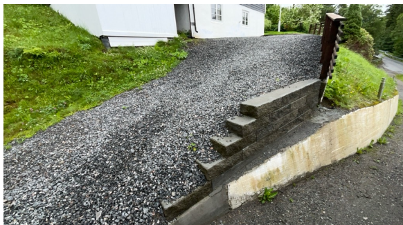
Mangler rekkverk på nedre del av støttemur
