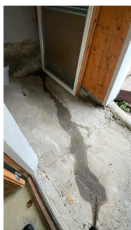
Synlig fukt i rom inn til kjeller utenfor kjellerdøren.
