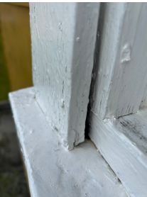
Glippe mellom vindu og trebord(åpent inn)
