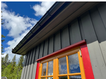
Ingen lufting i nedre del av takkonstruksjon
