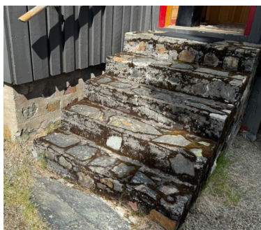
Trapp ved inngang uten rekkverk og mose på overflater
