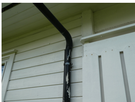
Lekkasje i taknedløpet
