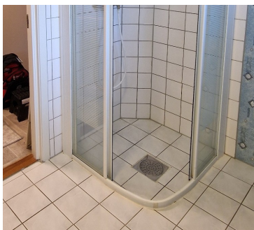
Gulvramme hindrer avrenning til sluk
