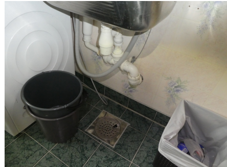
Manglende mensjett - avløpsrør for skyllekum
