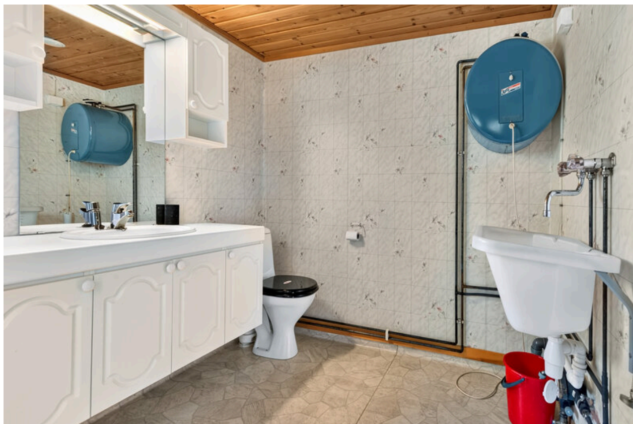
Bad med gulvstående toalett, utslagsvask, varmtvannsbereider, opplegg for vaskemaskin og vegghengt servanttinnredning med spill med overlys.
