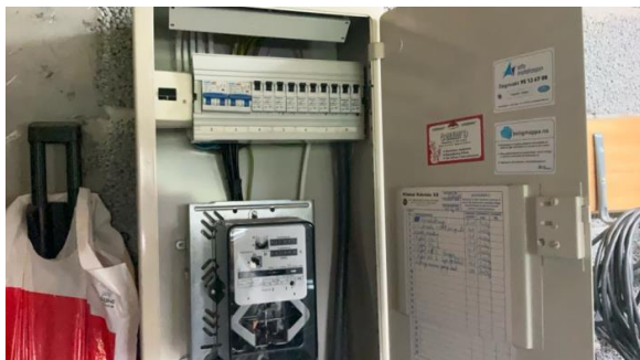
Sikringsskap med automatsikringer er plassert i garasje.
