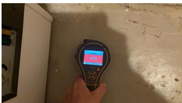
Fuktmåling indikerer fuktvandring og fuktopptrekk via kjellervegg.
