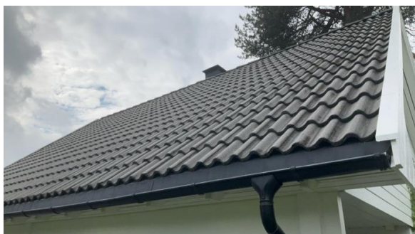
Det mangler snøfanger på takflatene.
