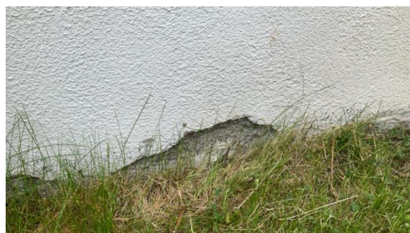
Stedvis avskallinger på murpuss.
