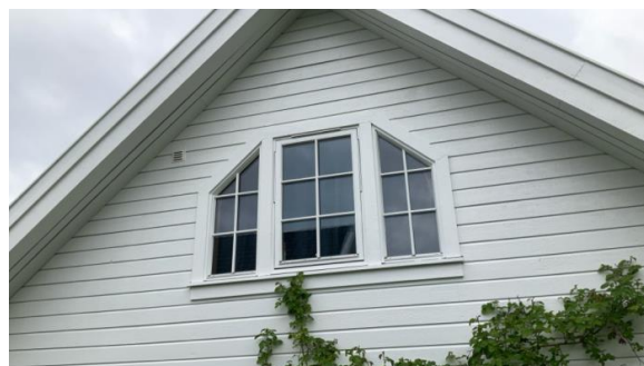
Det er ikke montert beslag på vannbrett over og under vinduer.
