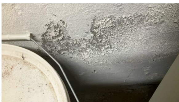
Saltutslag og malingsflass på vegger er registrert.
