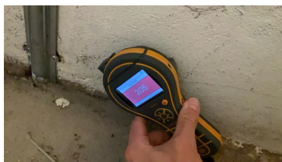
Fuktmåling indikerer fuktvandring og fuktopptrekk via kjellergulv.
