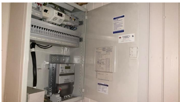
Sikringsskap med automatsikringer er plassert i kjellernedgang.
