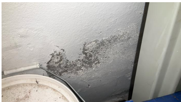
Malingsflass, salutslag og avskalling av murpuss på vegg, dette indikerer fuktvandring i vegger.
