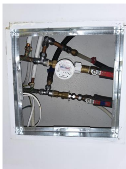
Fordelerskap og fordelerstammer - Fordelerstammer og stoppekraner
