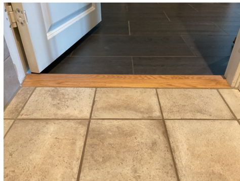
Vanntett sjikt er ikke ført min. 15mm over ferdig gulv ved terskel.
