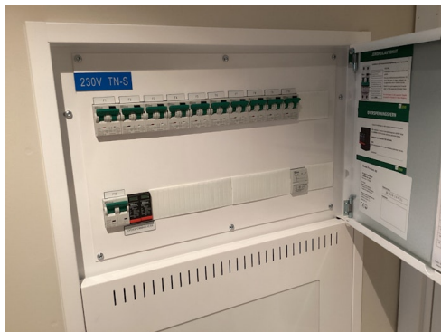
Bilde av sikringskap.
